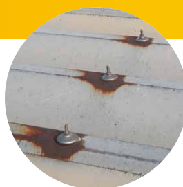
圖 5：扣件周邊屋頂板銹蝕示例
